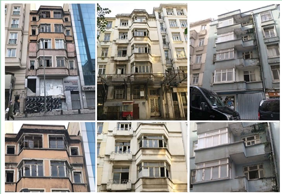
Şekil 28. Strüktürel çatlak, malzeme kaybı ve yapısal bozulmalar gözlenen yapı örnekleri (Yazarların arşivi, 2020).
